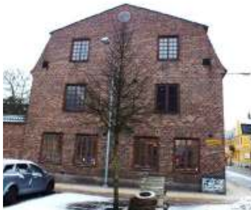
Foto på flygelns gavelfasad som visar bytet av fönster till ventilationsgaller.
