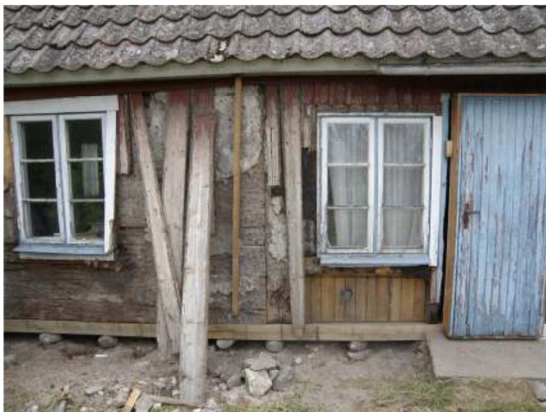
Fig. 1. Västra långsidan, nytt fotträ på plats och stenfoten justerad. Notera den kvarsittande putsen mellan fönstren.
